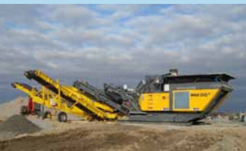
Дробильная установка RM80 GO! с электроприводом в совместной работе с двухуровневым виброгрохотом CS3600/2 и конвейером возврата негабаритной фракции
